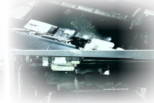
포항 S아파트 승강기 침수
